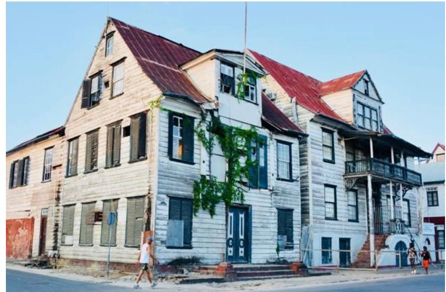
Afb.40 : Een gebouw aan de prominente Waterkant dat in een slechte staat verkeert en gerestaureerd zal worden via PURP (Green, 2019)
