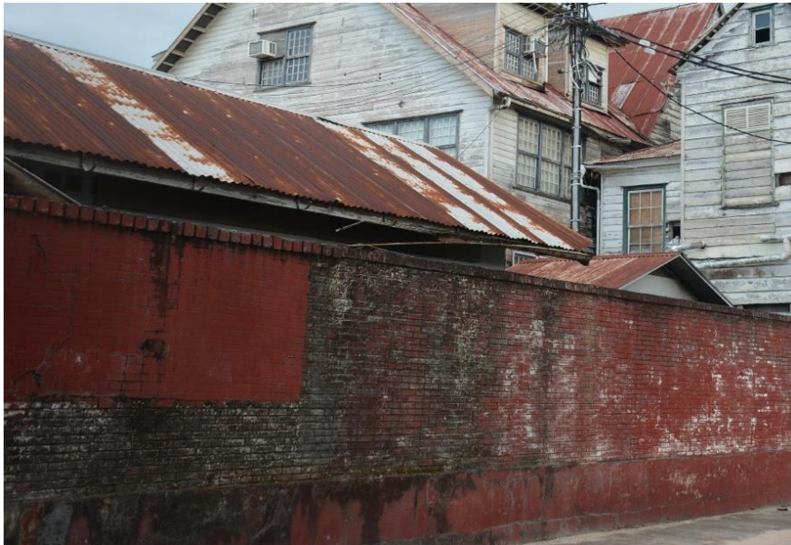
Afb. 22–Bouwwerken aan de achterzijde van de percelen waarin tot slaaf gemaakte personen en de keukens gehuisvest waren, zijn grotendeels vergeten en slechts enkele zijn overgebleven (Green, 2018)
